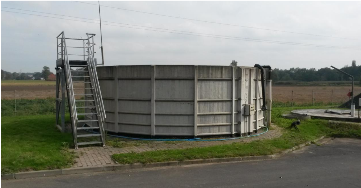
Rys. 2 zbiornik zagęszczacza osadów
